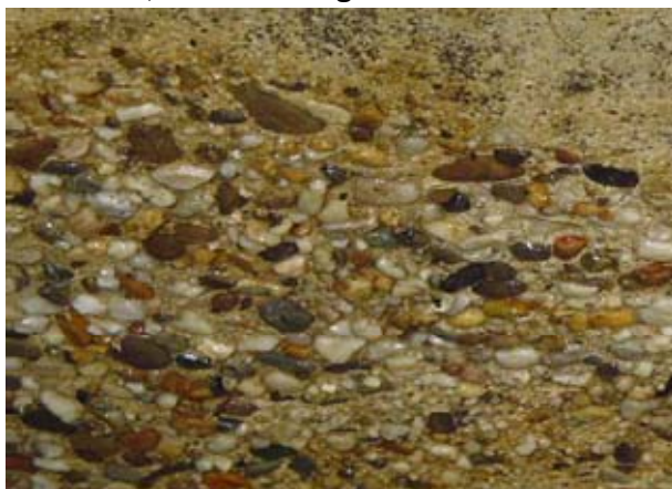
Aangetaste betonnen riolering
