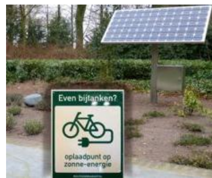
elektrisch oplaadpunt op zonne-energie
